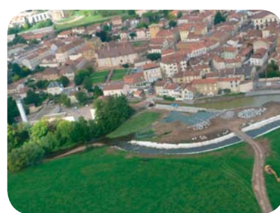
Détournement temporaire du Sornin pour reconstruire le seuil des pompiers à Charlieu
